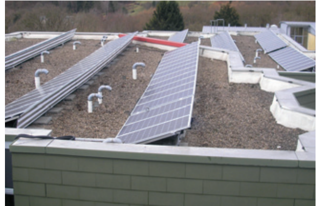
Blick auf die Solaranlage von Haus IV der Wohnanlage Tarforst
